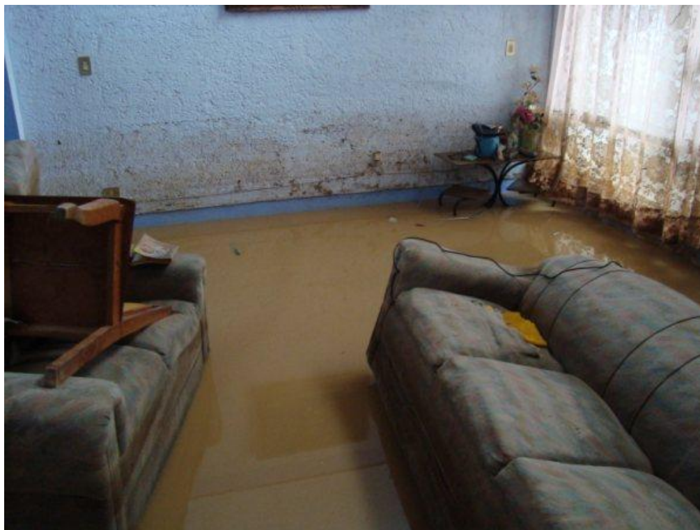
Fig. 2.5.- Casa en la calle Perote afectada por las inundaciones (Foto: Mayra Zavaleta Castillo)
