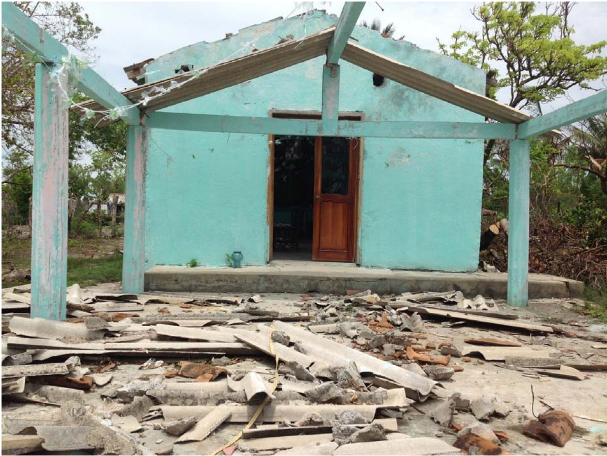
Imágenes del templo católico luego del huracán Bárbara en la población de Cachimbo, 2013 42
