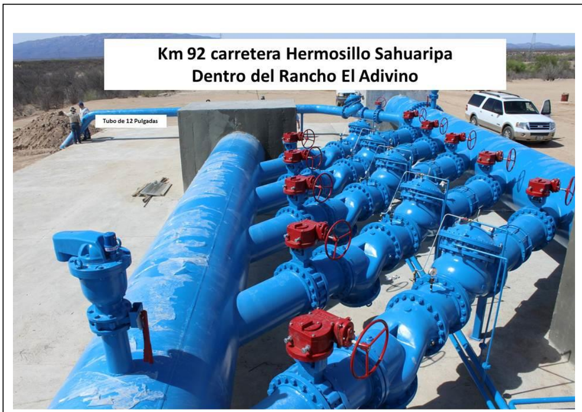
Figura 2. Estación de rebombeo (tramo a presión) al interior del rancho El Adivino
