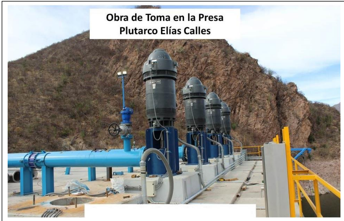
Figura 1. Obra de toma del Acueducto Independencia en la presa El Novillo (Plutarco Elías Calles)
