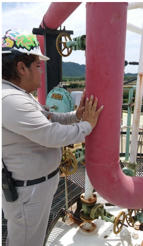
Foto 4. Norma, explicando las válvulas del tanque capsula (Foto propia 25/07/2017)
